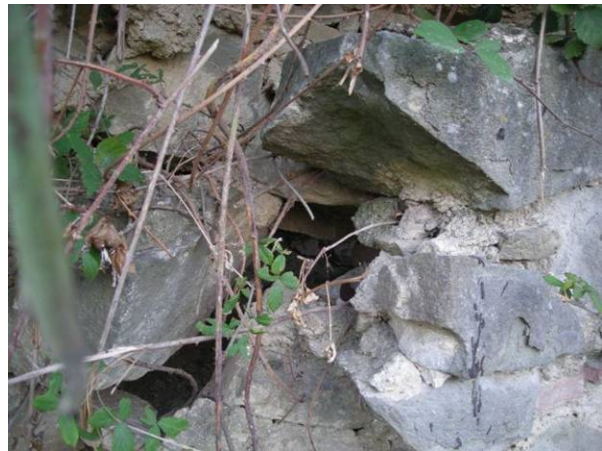
Un primo piano del danno
